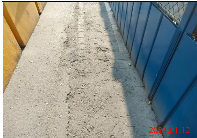
巡查日期地點：113.01.12/ Y23車站 照片說明：路面龜裂狀況
