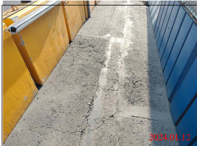
巡查日期地點：113.01.12/ Y23車站 照片說明：路面龜裂狀況
