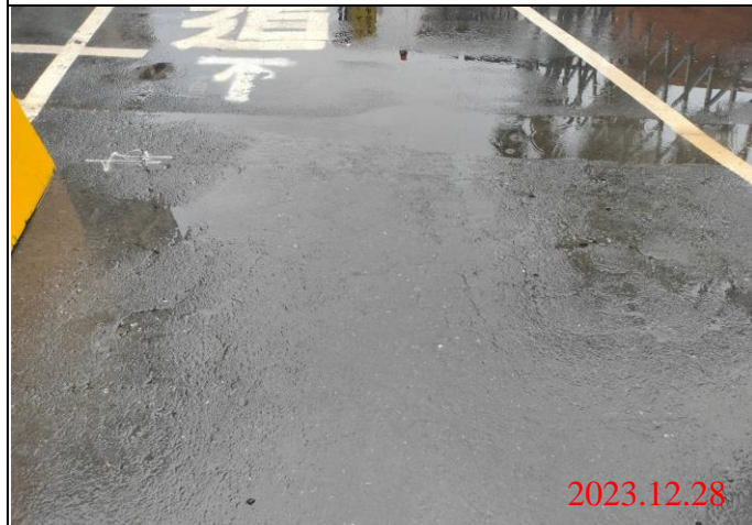
巡查日期地點：112.12.28/ Y23車站 照片說明：路面龜裂狀況
