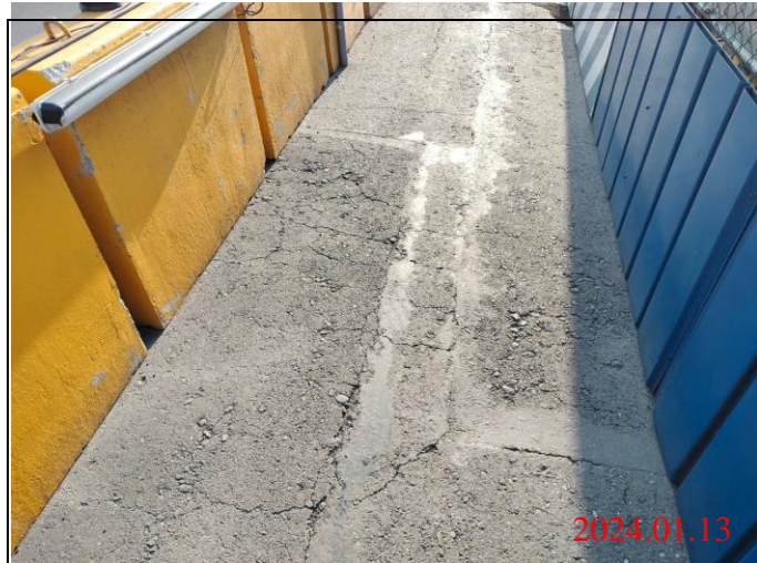
巡查日期地點：113.01.13/ Y23車站 照片說明：路面龜裂狀況
