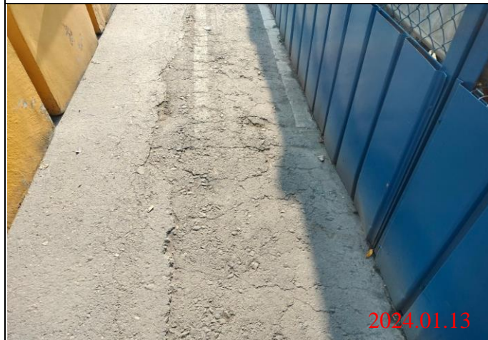
巡查日期地點：113.01.13/ Y23車站 照片說明：路面龜裂狀況
