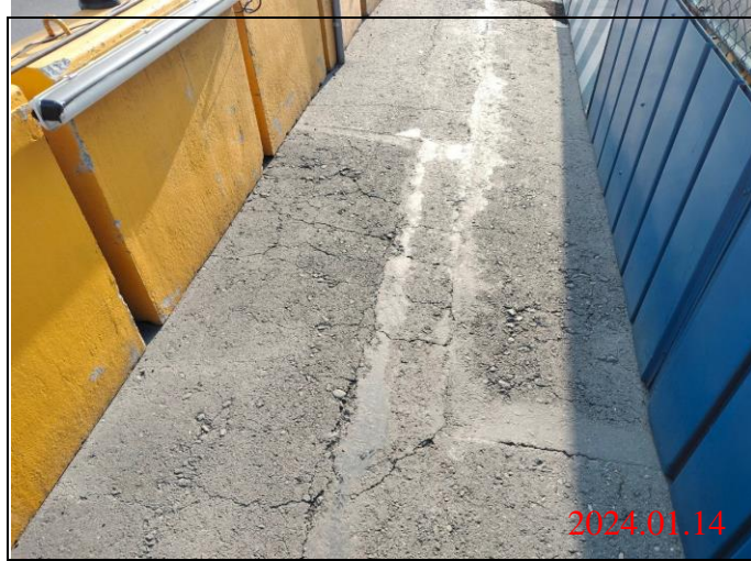
巡查日期地點：113.01.14/ Y23車站 照片說明：路面龜裂狀況
