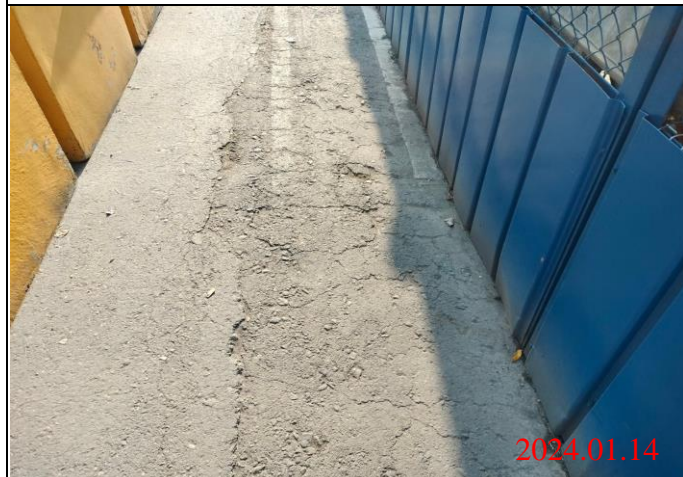
巡查日期地點：113.01.14/ Y23車站 照片說明：路面龜裂狀況
