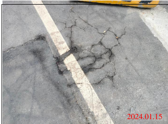
巡查日期地點：113.01.15/ Y23車站 照片說明：路面龜裂狀況
