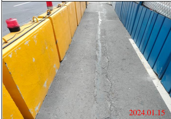
巡查日期地點：113.01.15/ Y23車站 照片說明：路面龜裂狀況
