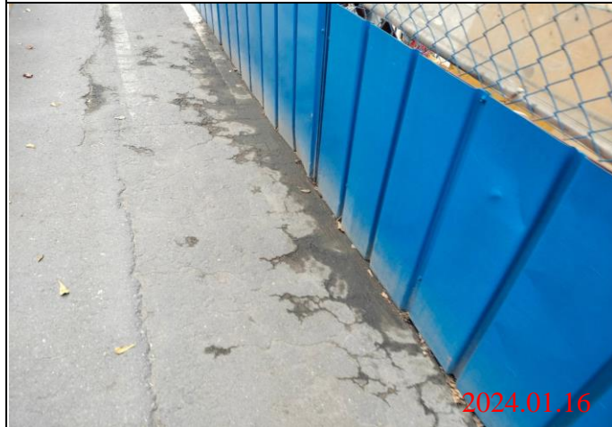
巡查日期地點：113.01.16/ Y23車站 照片說明：路面龜裂狀況
