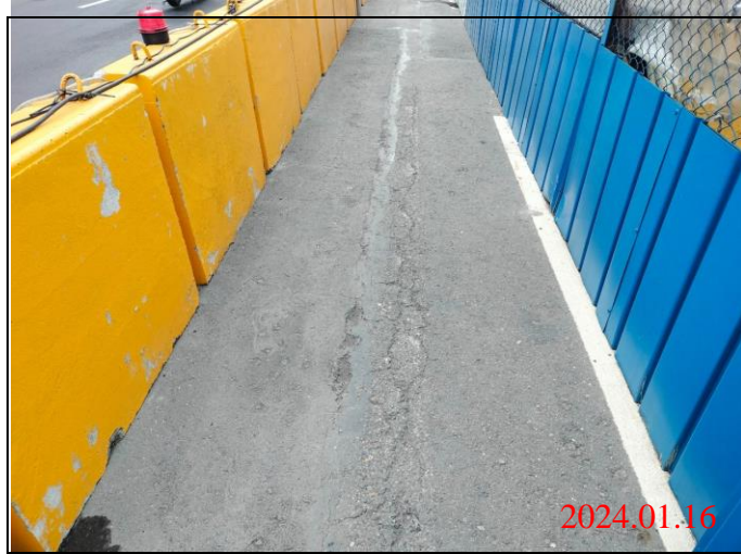
巡查日期地點：113.01.16/ Y23車站 照片說明：路面龜裂狀況
