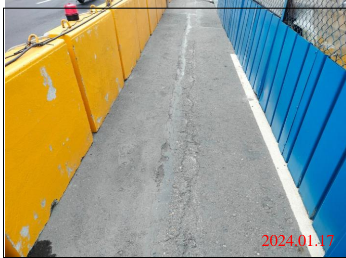
巡查日期地點：113.01.17/ Y23車站 照片說明：路面龜裂狀況
