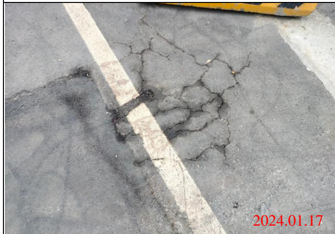
巡查日期地點：113.01.17/ Y23車站 照片說明：路面龜裂狀況
