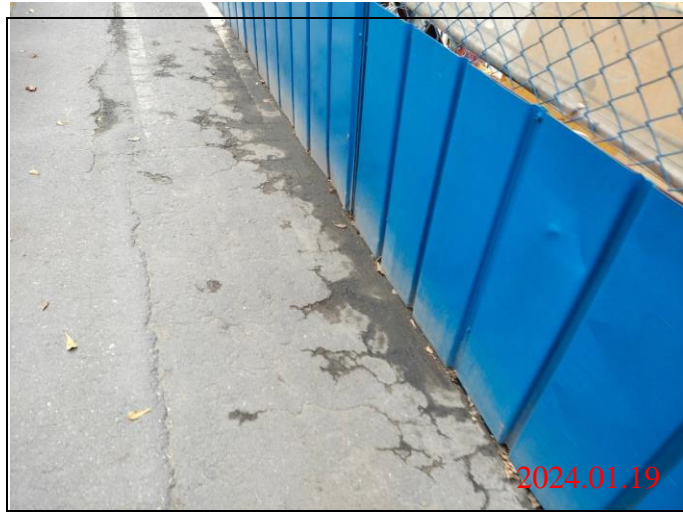
巡查日期地點：113.01.19/ Y23車站 照片說明：路面龜裂狀況
