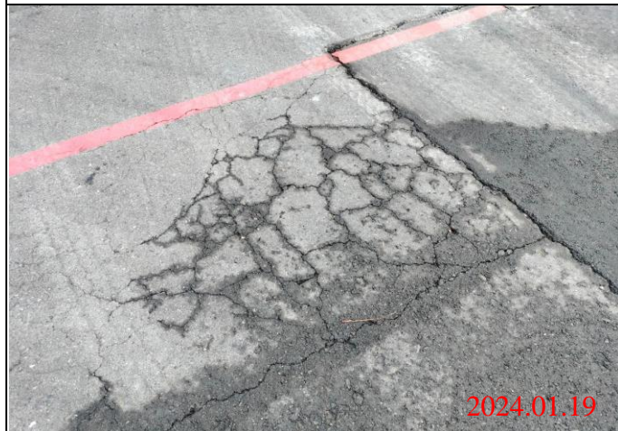
巡查日期地點：113.01.19/ Y23車站 照片說明：路面龜裂狀況
