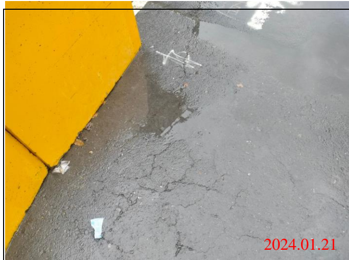
巡查日期地點：113.01.21/ Y23車站 照片說明：路面龜裂狀況
