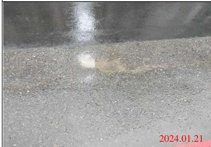
巡查日期地點：113.01.21/ Y23車站 照片說明：路面龜裂狀況
