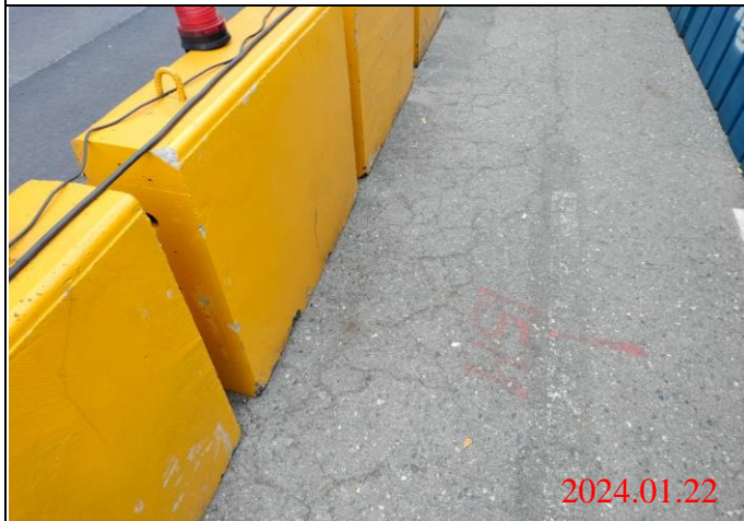
巡查日期地點：113.01.22 Y23車站 照片說明：路面龜裂狀況
