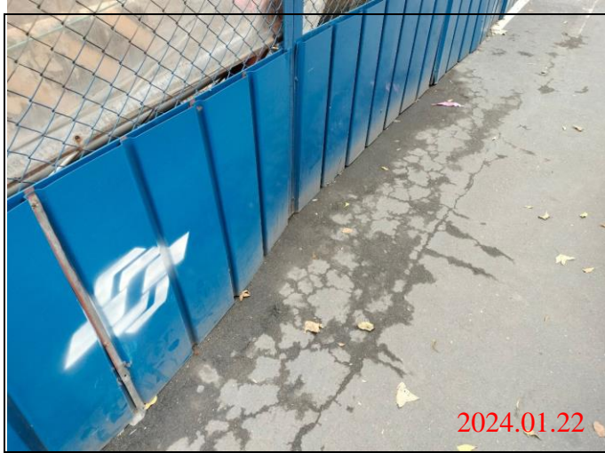
巡查日期地點：113.01.22/ Y23車站 照片說明：路面龜裂狀況
