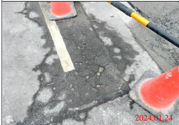
巡查日期地點：113.01.24/ Y23車站 照片說明：路面龜裂狀況
