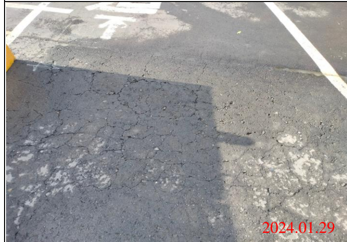
巡查日期地點：113.01.29/ Y23車站 照片說明：路面龜裂狀況
