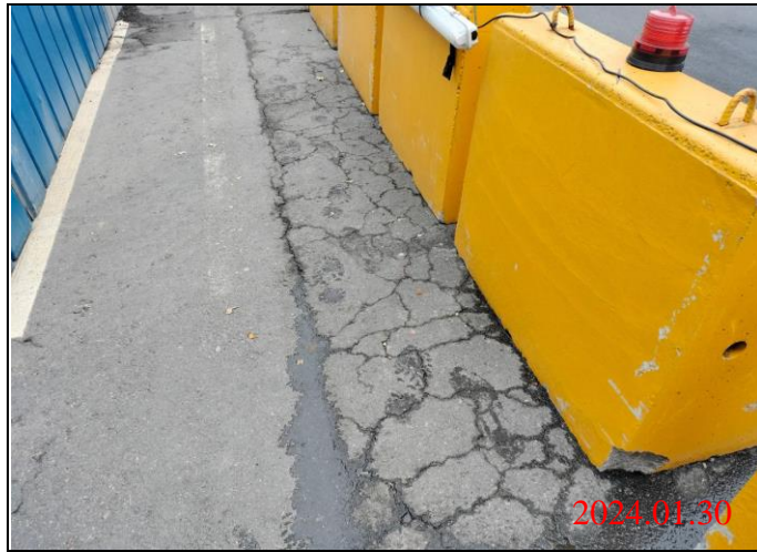
巡查日期地點：113.01.30/ Y23車站 照片說明：路面龜裂狀況
