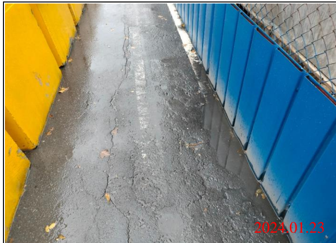
巡查日期地點：113.01.23/ Y23車站 照片說明：路面龜裂狀況
