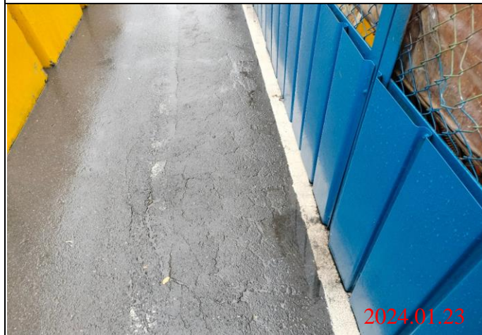
巡查日期地點：113.01.23/ Y23車站 照片說明：路面龜裂狀況
