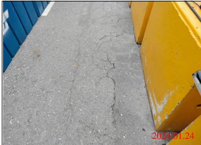
巡查日期地點：113.01.24/ Y23車站 照片說明：路面龜裂狀況
