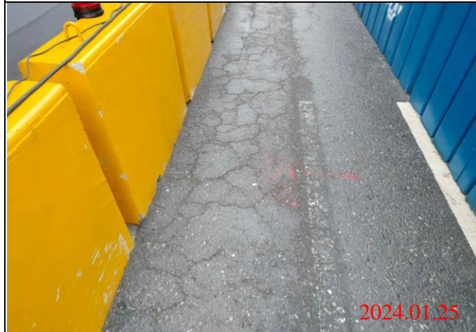
巡查日期地點：113.01.25/ Y23車站 照片說明：路面龜裂狀況
