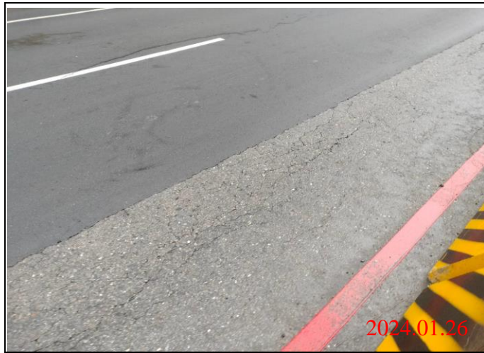
巡查日期地點：113.01.26/ Y23車站 照片說明：路面龜裂狀況
