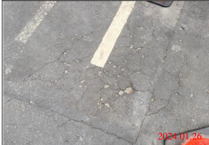
巡查日期地點：113.01.26/ Y23車站 照片說明：路面龜裂狀況
