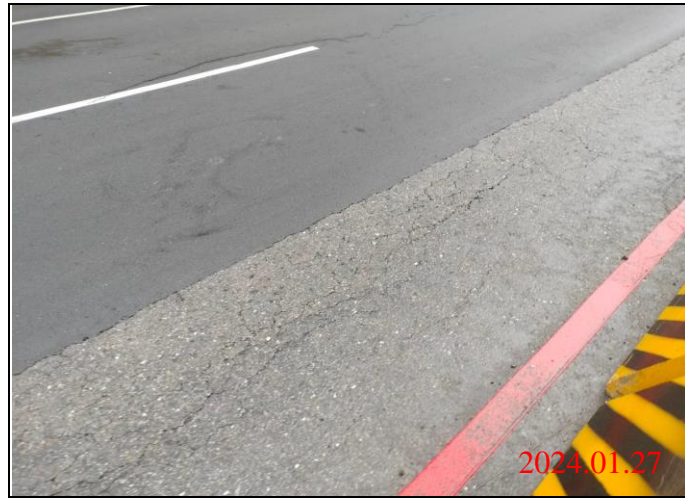
巡查日期地點：113.01.27/ Y23車站 照片說明：路面龜裂狀況
