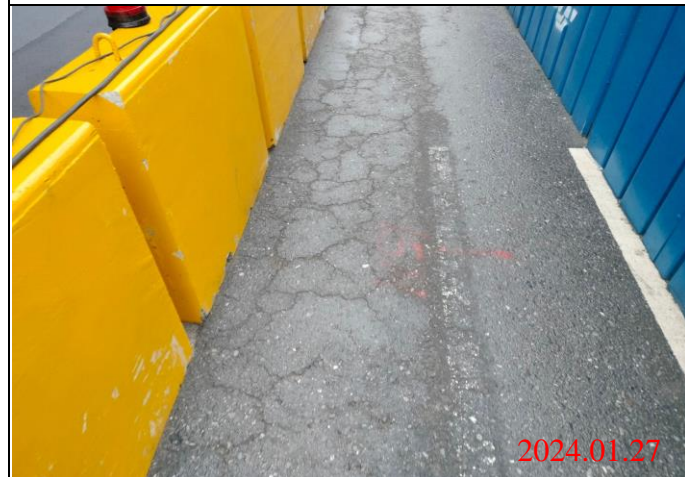
巡查日期地點：113.01.27/ Y23車站 照片說明：路面龜裂狀況
