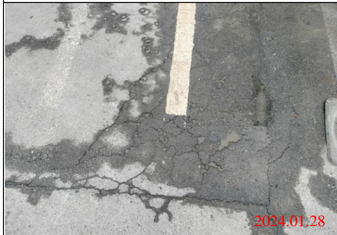
巡查日期地點：113.01.28/ Y23車站 照片說明：路面龜裂狀況
