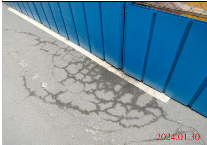
巡查日期地點：113.01.30/ Y23車站 照片說明：路面龜裂狀況
