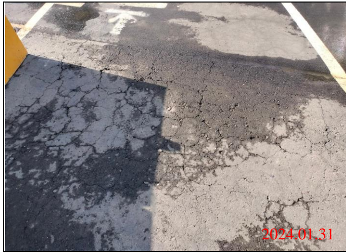
巡查日期地點：113.01.31/ Y23車站 照片說明：路面龜裂狀況
