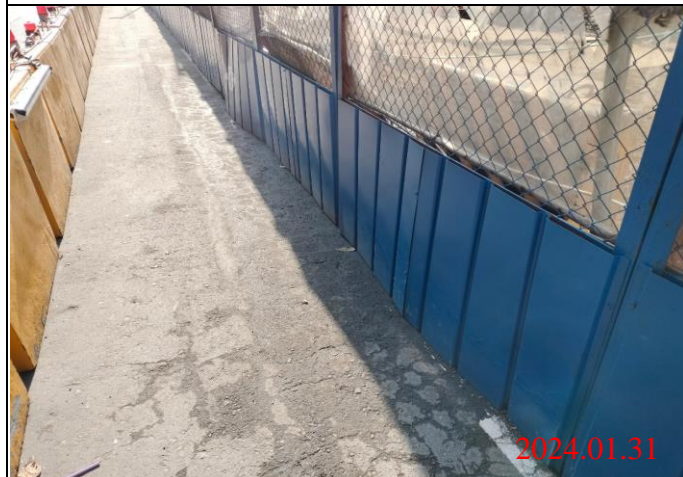
巡查日期地點：113.01.31/ Y23車站 照片說明：路面龜裂狀況
