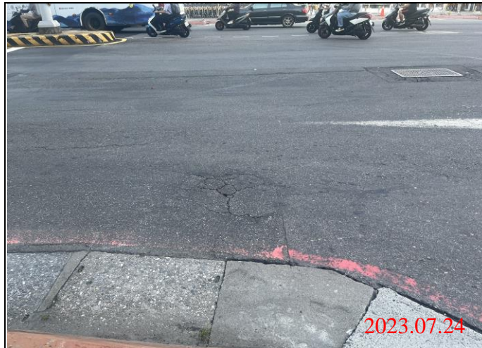
巡查日期地點：112.07.24/ Y21車站 照片說明：路面龜裂狀況
