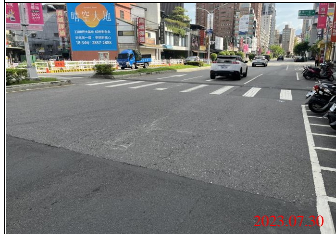
巡查日期地點：112.07.30/ Y21車站 照片說明：路面龜裂狀況
