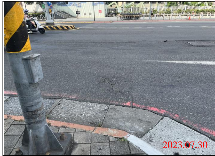
巡查日期地點：112.07.30/ Y21車站 照片說明：路面龜裂狀況
