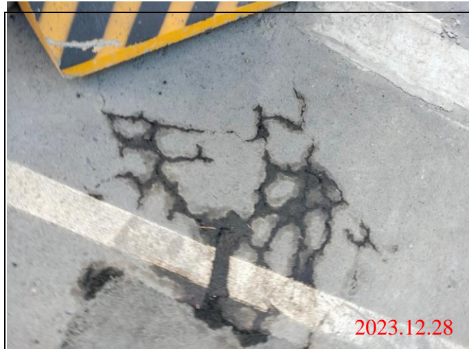
巡查日期地點：112.12.28/ Y23車站 照片說明：路面龜裂狀況
