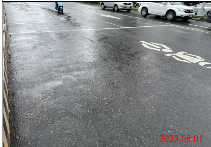
巡查日期地點：112.08.01/ Y22車站 照片說明：路面龜裂狀況
