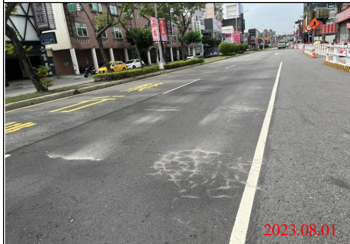
巡查日期地點：112.08.01/ Y21車站 照片說明：路面龜裂狀況
