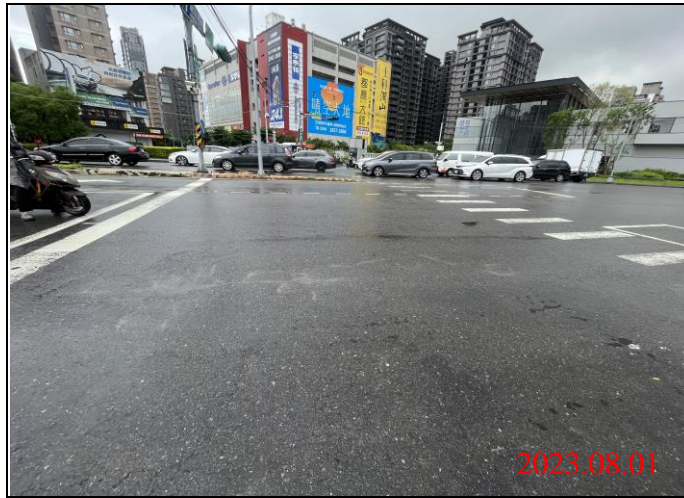
巡查日期地點：112.08.01/ Y22車站 照片說明：路面龜裂狀況
