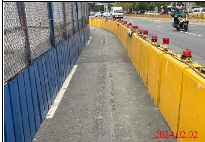
巡查日期地點：113.02.02/ Y23車站 照片說明：路面龜裂狀況
