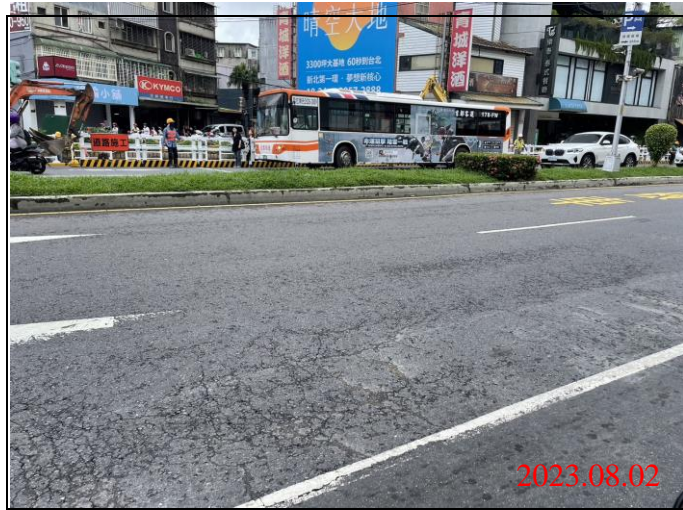
巡查日期地點：112.08.02/ Y21車站 照片說明：路面龜裂狀況
