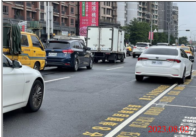
巡查日期地點：112.08.02/ Y23車站 照片說明：路面龜裂狀況
