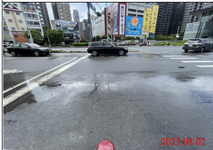
巡查日期地點：112.08.02/ Y22車站 照片說明：路面龜裂狀況
