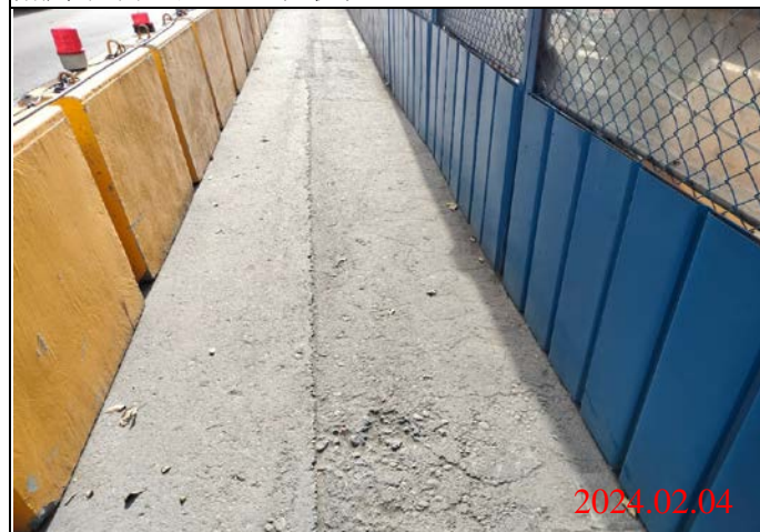
巡查日期地點：113.02.04/ Y23車站 照片說明：路面龜裂狀況
