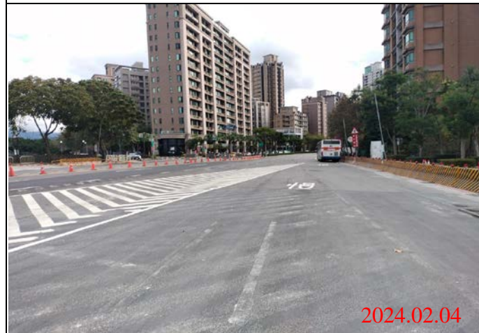
巡查日期地點：113.02.04/ Y22車站 照片說明：路面狀況
