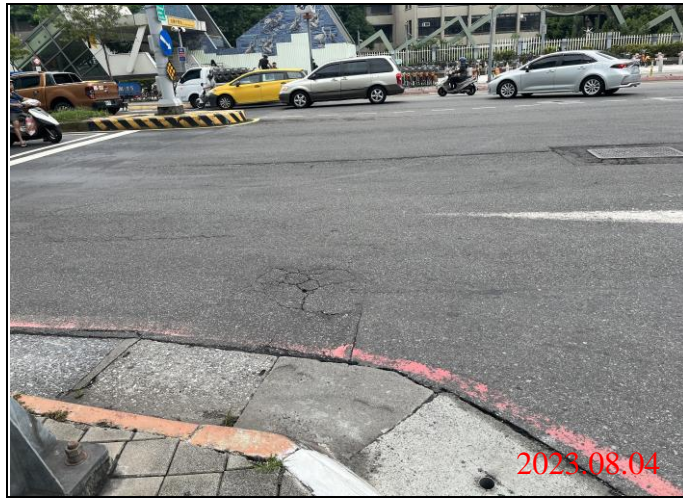
巡查日期地點：112.08.04/ Y21車站 照片說明：路面龜裂狀況
