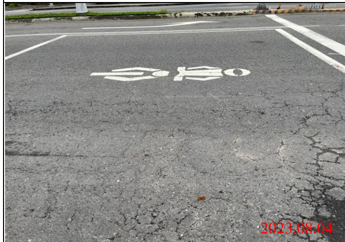
巡查日期地點：112.08.04/ Y22車站 照片說明：路面龜裂狀況
