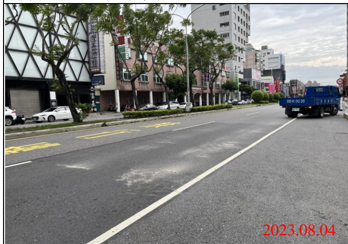
巡查日期地點：112.08.04/ Y21車站 照片說明：路面龜裂狀況
