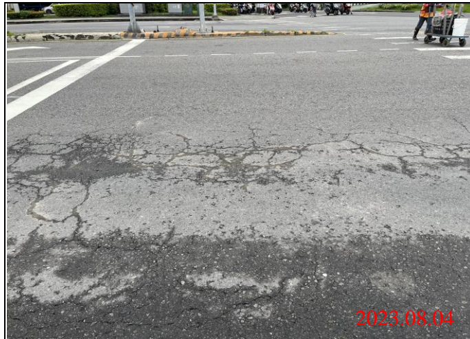
巡查日期地點：112.08.04/ Y22車站 照片說明：路面龜裂狀況
