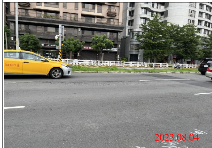
巡查日期地點：112.08.04/ Y23車站 照片說明：路面龜裂狀況
