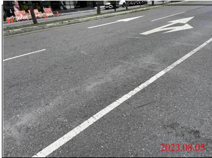
巡查日期地點：112.08.05/ Y21車站 照片說明：路面龜裂狀況
