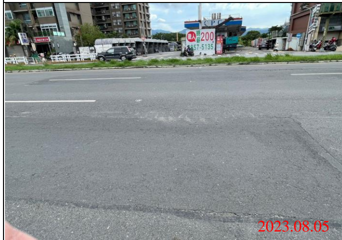
巡查日期地點：112.08.05/ Y23車站 照片說明：路面龜裂狀況
