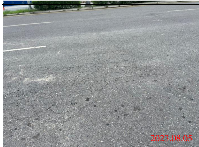
巡查日期地點：112.08.05/ Y22車站 照片說明：路面龜裂狀況
