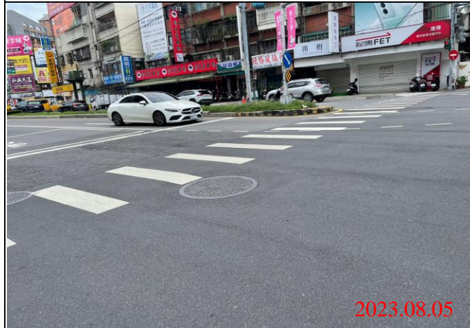
巡查日期地點：112.08.05/ Y21車站 照片說明：路面龜裂狀況
