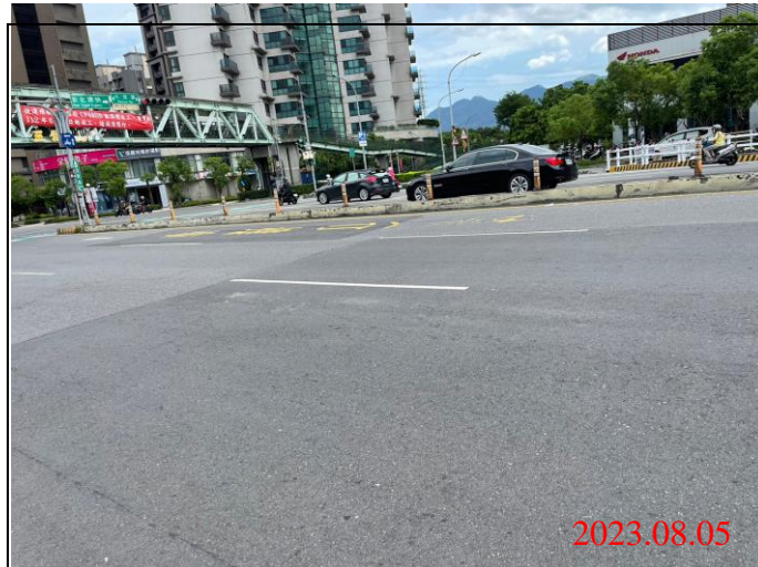
巡查日期地點：112.08.05/ Y23車站 照片說明：路面龜裂狀況
