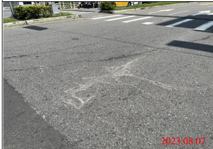
巡查日期地點：112.08.07/ Y21車站 照片說明：路面龜裂狀況
