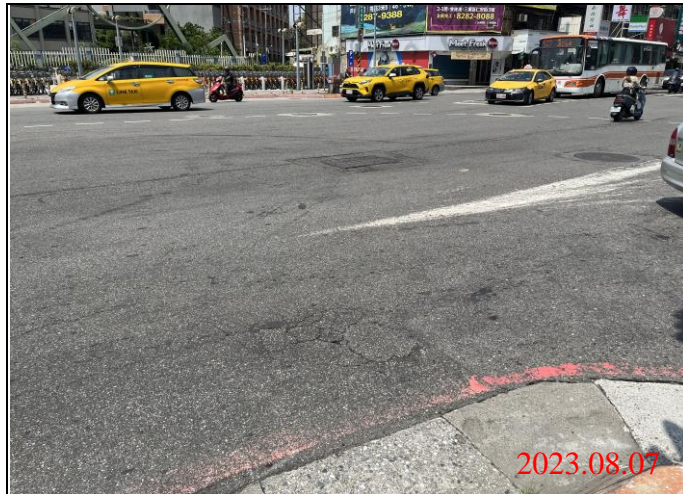
巡查日期地點：112.08.07/ Y21車站 照片說明：路面龜裂狀況
