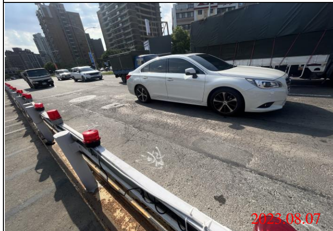
巡查日期地點：112.08.07/ Y22車站 照片說明：路面龜裂狀況
