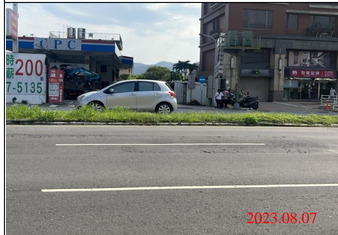
巡查日期地點：112.08.07/ Y23車站 照片說明：路面龜裂狀況
