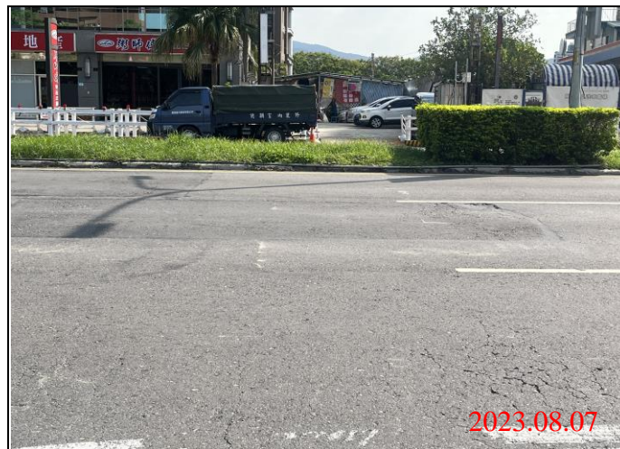
巡查日期地點：112.08.07/ Y23車站 照片說明：路面龜裂狀況
