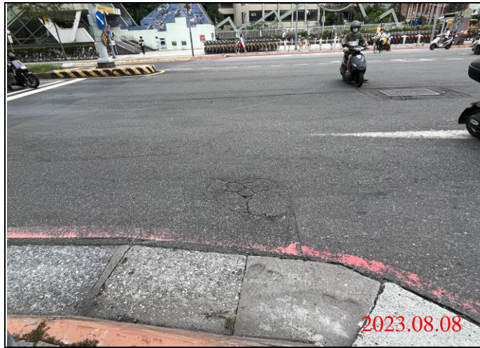
巡查日期地點：112.08.08/ Y21車站 照片說明：路面龜裂狀況
