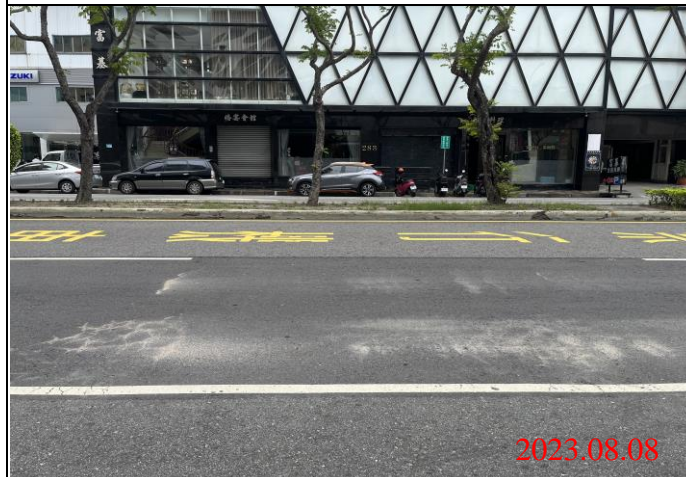
巡查日期地點：112.08.08/ Y21車站 照片說明：路面龜裂狀況
