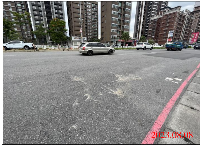
巡查日期地點：112.08.08/ Y23車站 照片說明：路面龜裂狀況
