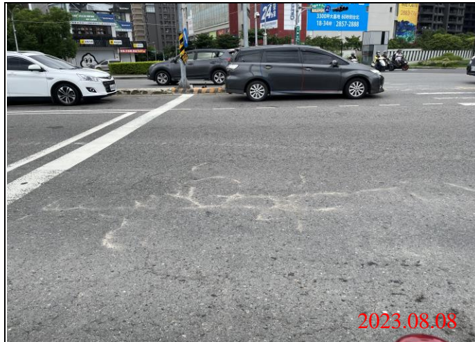
巡查日期地點：112.08.08/ Y22車站 照片說明：路面龜裂狀況
