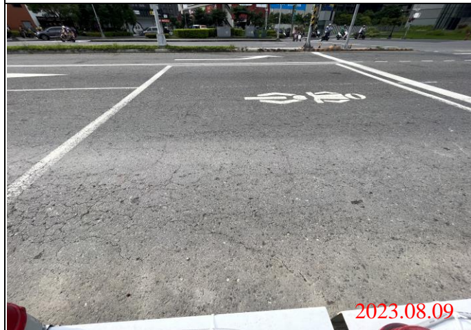
巡查日期地點：112.08.09/ Y22車站 照片說明：路面龜裂狀況
