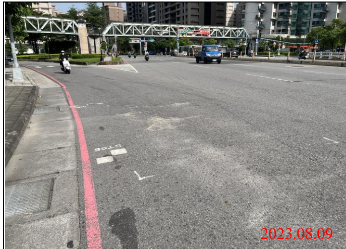
巡查日期地點：112.08.09/ Y23車站 照片說明：路面龜裂狀況
