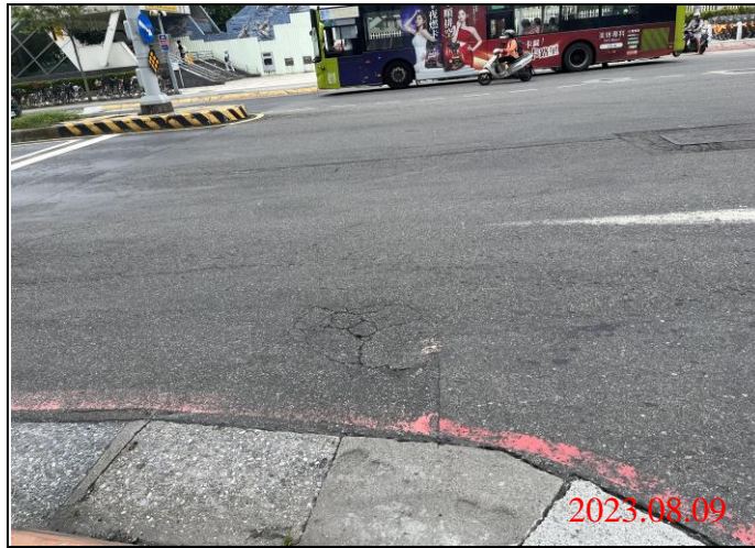
巡查日期地點：112.08.09/ Y21車站 照片說明：路面龜裂狀況
