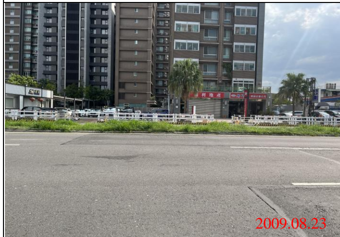
巡查日期地點：112.08.09/ Y233車站 照片說明：路面龜裂狀況
