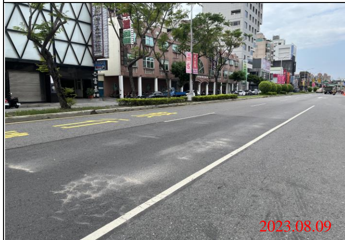
巡查日期地點：112.08.09/ Y21車站 照片說明：路面龜裂狀況
