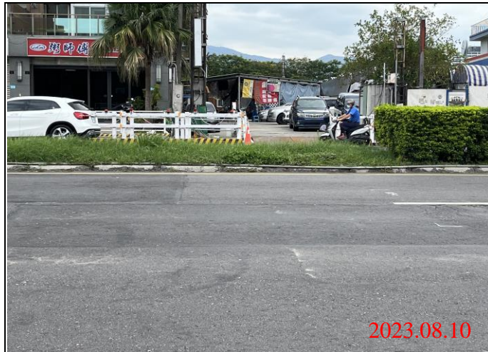
巡查日期地點：112.08.10/ Y23車站 照片說明：路面龜裂狀況
