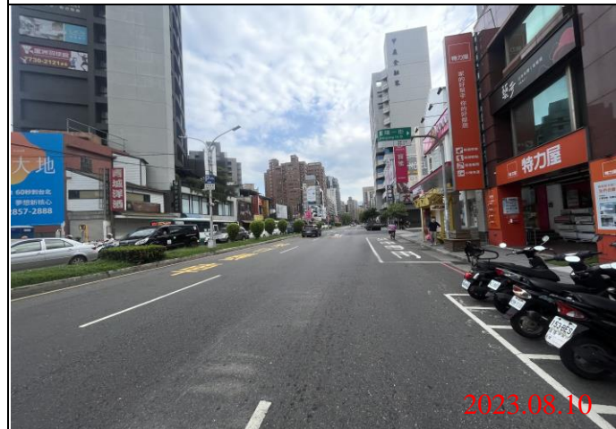
巡查日期地點：112.08.10/ Y21車站 照片說明：路面龜裂狀況
