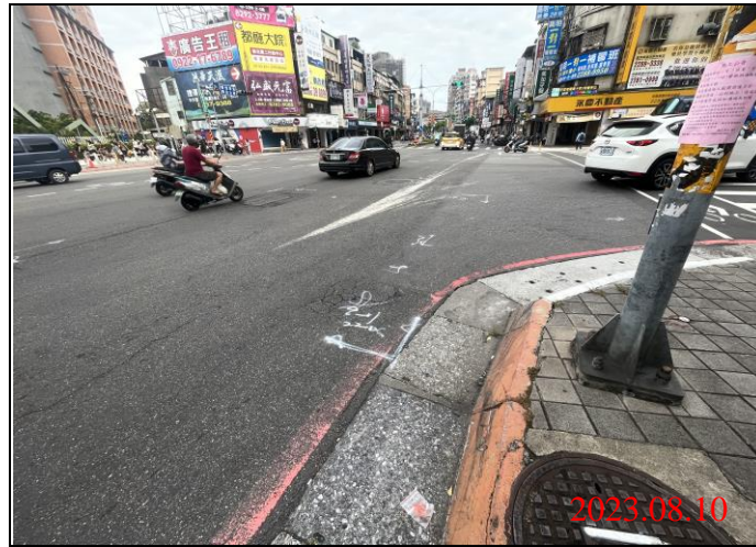
巡查日期地點：112.08.10/ Y21車站 照片說明：路面龜裂狀況
