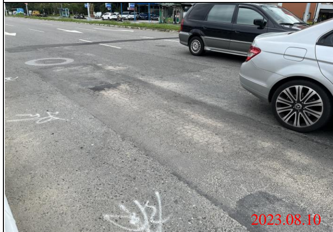
巡查日期地點：112.08.10/ Y22車站 照片說明：路面龜裂狀況
