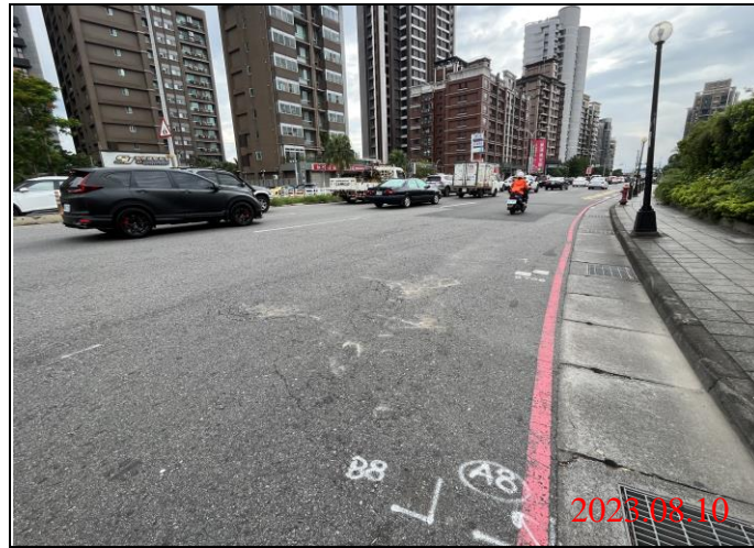
巡查日期地點：112.08.10/ Y23車站 照片說明：路面龜裂狀況
