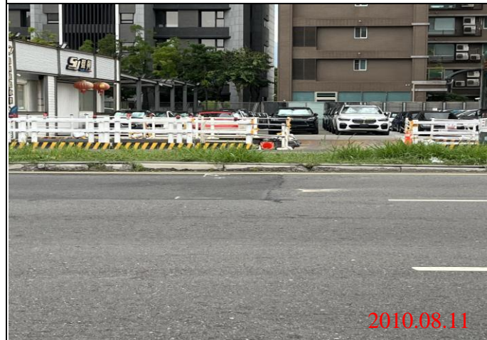
巡查日期地點：112.08.11+6/ Y23車站 照片說明：路面龜裂狀況
