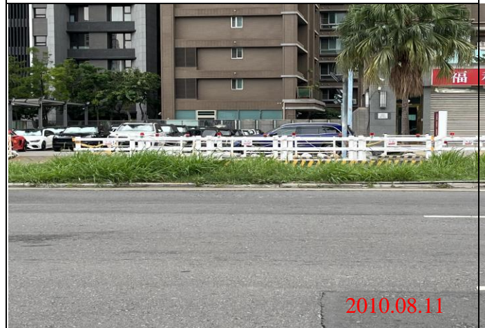
巡查日期地點：112.08.11/ Y23車站 照片說明：路面龜裂狀況
