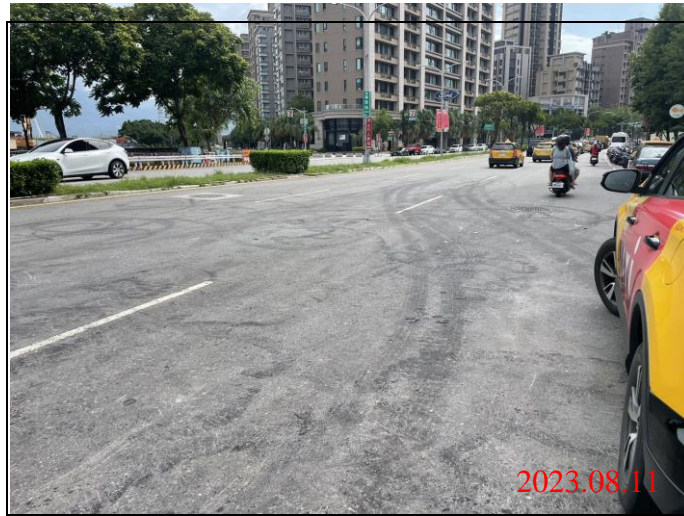
巡查日期地點：112.08.11/ Y22車站 照片說明：路面龜裂狀況
