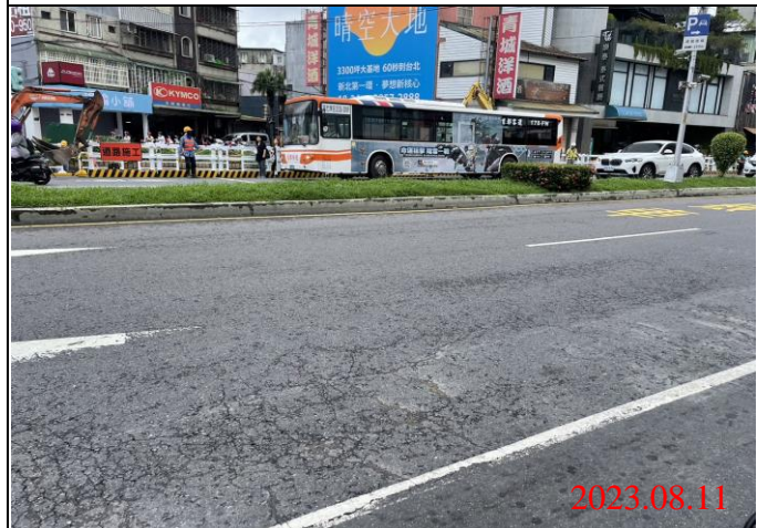
巡查日期地點：112.08.11/ Y21車站 照片說明：路面龜裂狀況
