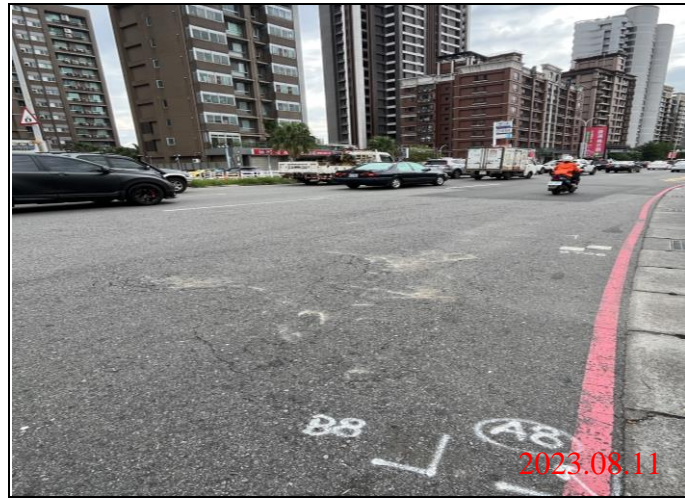
巡查日期地點：112.08.11/ Y23車站 照片說明：路面龜裂狀況
