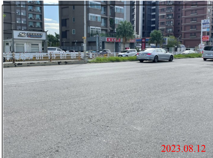
巡查日期地點：112.08.12/ Y23車站 照片說明：路面龜裂狀況
