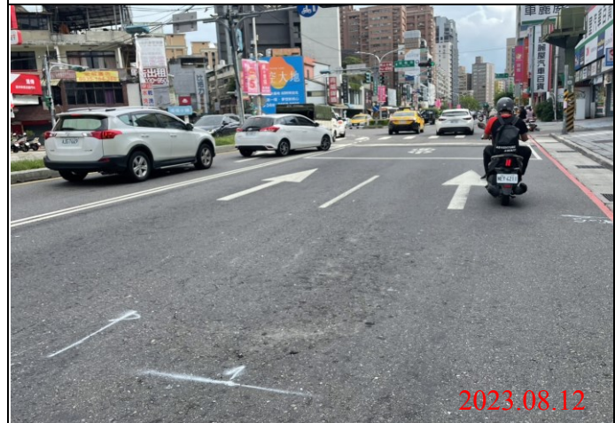
巡查日期地點：112.08.12/ Y21車站 照片說明：路面龜裂狀況
