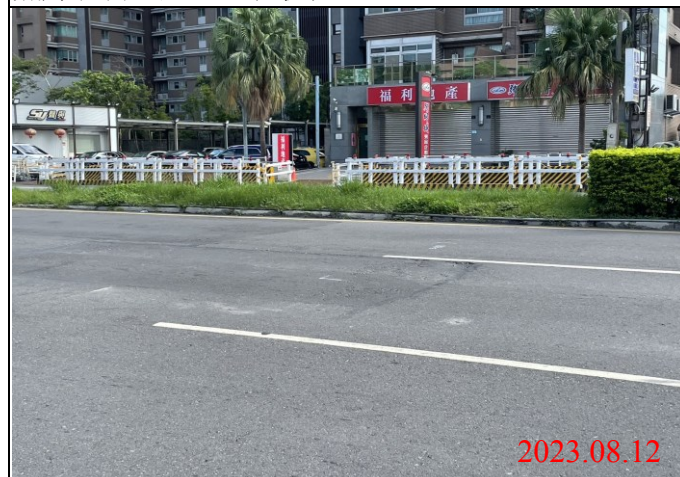
巡查日期地點：112.08.12/ Y23車站 照片說明：路面龜裂狀況
