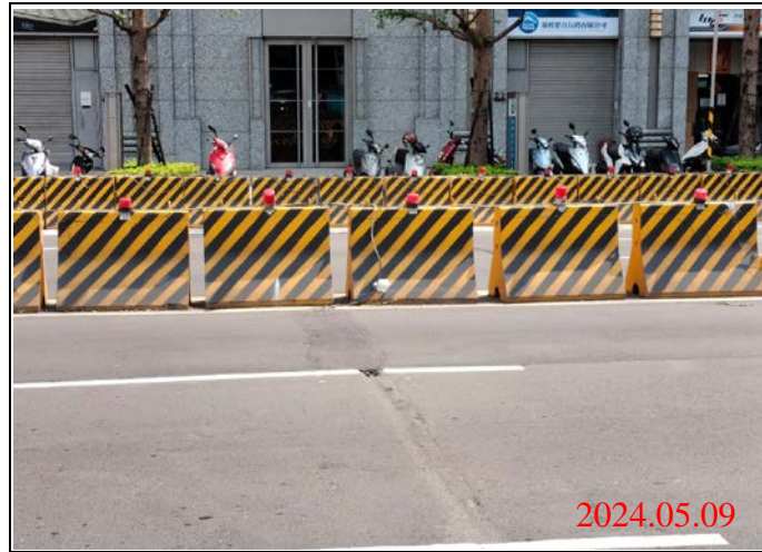
巡查日期地點：113.05.09/ Y23車站 照片說明：道路龜裂
