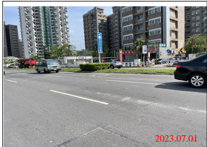
巡查日期地點：112.07.01/ Y23車站 照片說明：路面龜裂狀況
