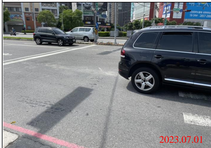
巡查日期地點：112.07.01/ Y22車站 照片說明：路面龜裂狀況
