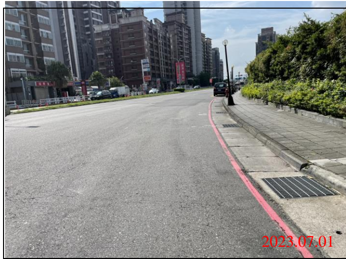
巡查日期地點：112.07.01/ Y23車站 照片說明：路面龜裂狀況
