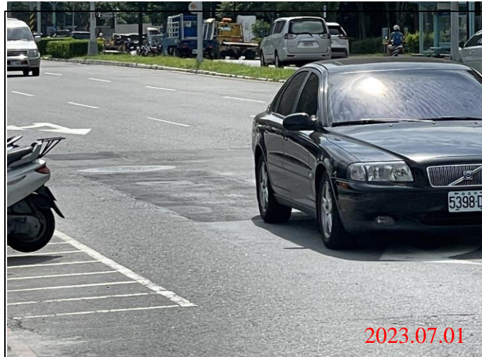
巡查日期地點：112.07.01/ Y22車站 照片說明：路面龜裂狀況
