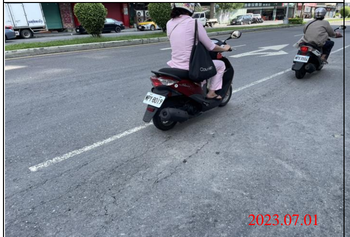
巡查日期地點：112.07.01/ Y21車站 照片說明：路面龜裂狀況
