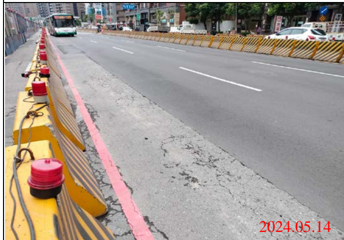
巡查日期地點：113.05.14/ Y23車站 照片說明：南側道路龜裂
