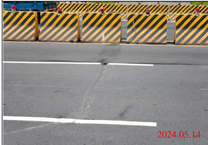
巡查日期地點：113.05.14/ Y23車站 照片說明：南側道路坑洞
