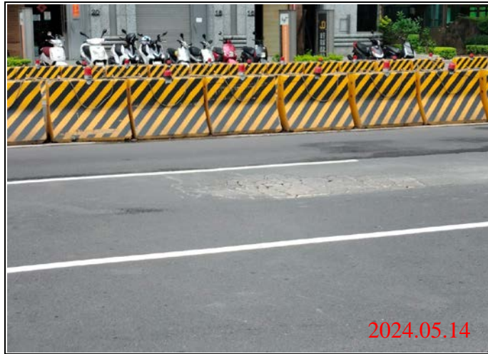
巡查日期地點：113.05.14/ Y23車站 照片說明：南側道路龜裂
