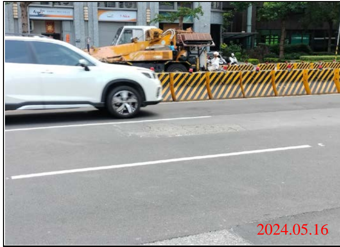
巡查日期地點：113.05.16/ Y23車站 照片說明：南側道路龜裂
