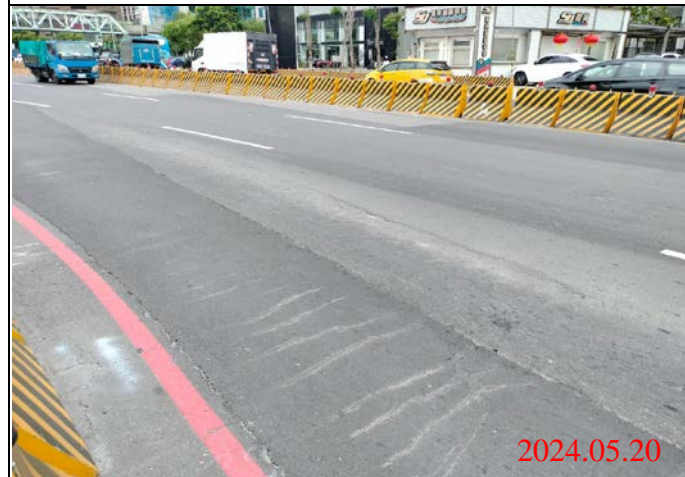
巡查日期地點：113.05.20/ Y23車站 照片說明：南側道路龜裂
