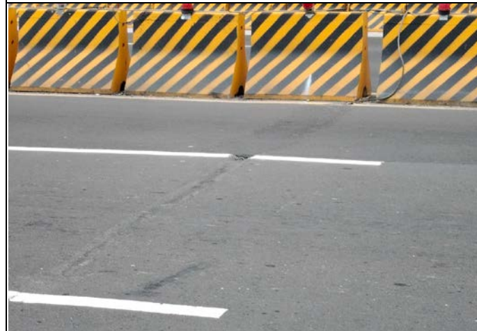
巡查日期地點：113.05.20/ Y23車站 照片說明：南側道路坑洞
