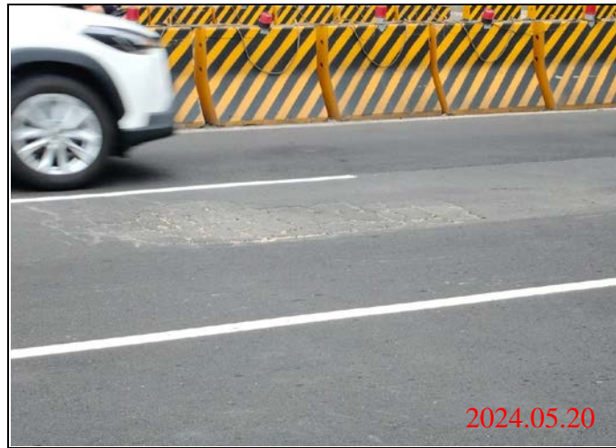
巡查日期地點：113.05.20/ Y23車站 照片說明：南側道路龜裂
