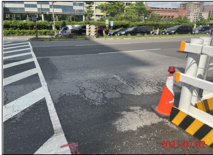
巡查日期地點：112.07.02/ Y23車站 照片說明：路面龜裂狀況
