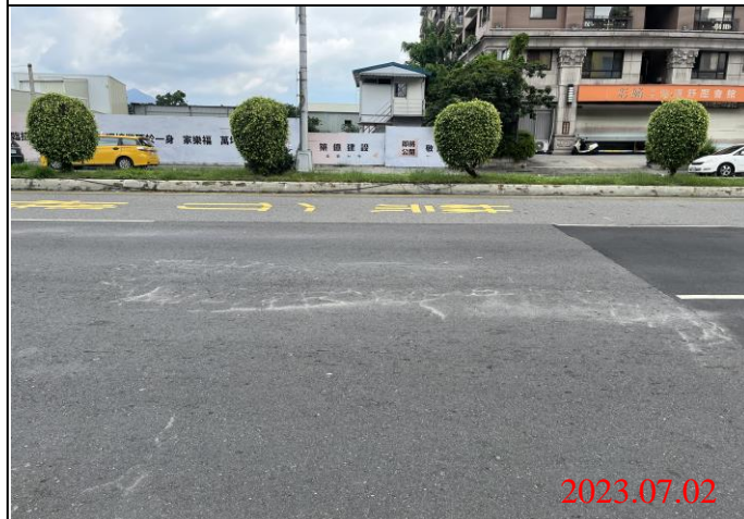
巡查日期地點：112.07.02/ Y22車站 照片說明：路面龜裂狀況
