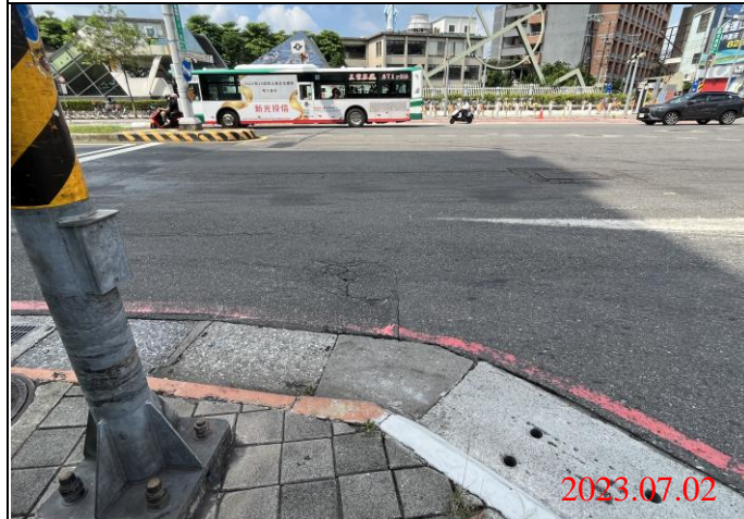
巡查日期地點：112.07.02/ Y21車站 照片說明：路面龜裂狀況
