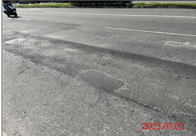
巡查日期地點：112.07.02/ Y2車站 照片說明：路面龜裂狀況
