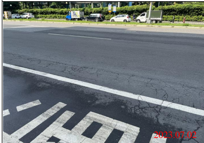
巡查日期地點：112.07.02/ Y23車站 照片說明：路面龜裂狀況
