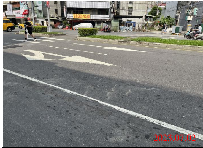
巡查日期地點：112.07.02/ Y21車站 照片說明：路面龜裂狀況
