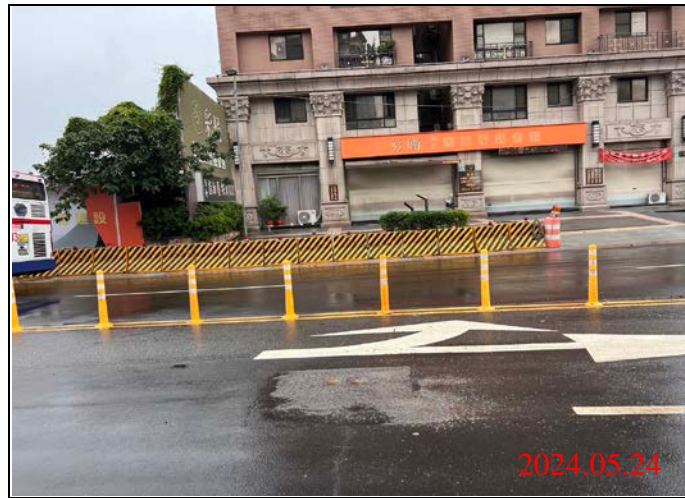
巡查日期地點：113.05.24/ Y22車站 照片說明：南側道路龜裂
