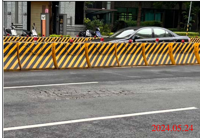
巡查日期地點：113.05.24/ Y23車站 照片說明：南側道路坑洞
