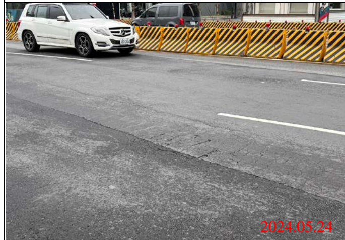
巡查日期地點：113.05.24/ Y23車站 照片說明：南側道路龜裂
