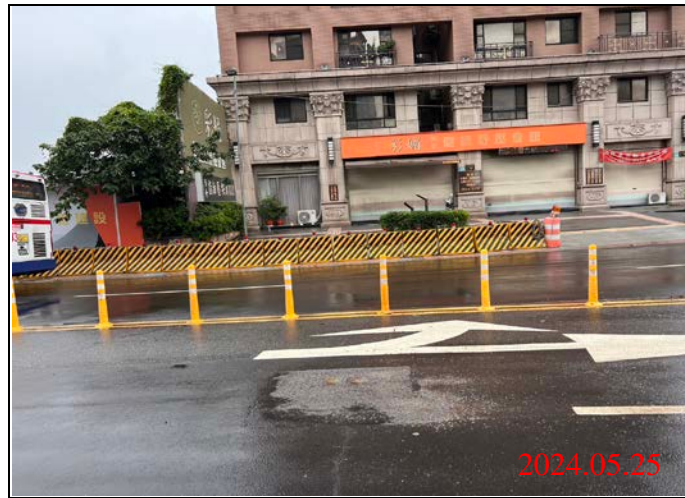
巡查日期地點：113.05.25/ Y22車站 照片說明：南側道路龜裂
