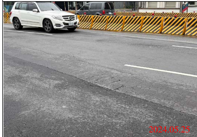
巡查日期地點：113.05.25/ Y23車站 照片說明：南側道路龜裂
