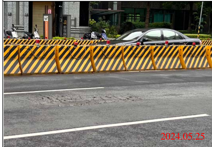
巡查日期地點：113.05.25/ Y23車站 照片說明：南側道路坑洞
