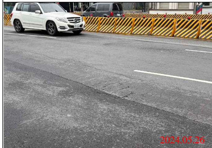
巡查日期地點：113.05.26/ Y23車站 照片說明：南側道路龜裂
