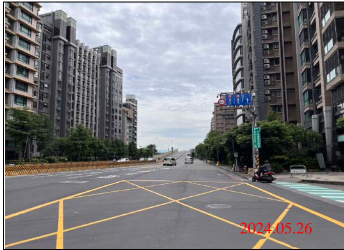
巡查日期地點：113.05.26/23車站 照片說明：路面狀況
