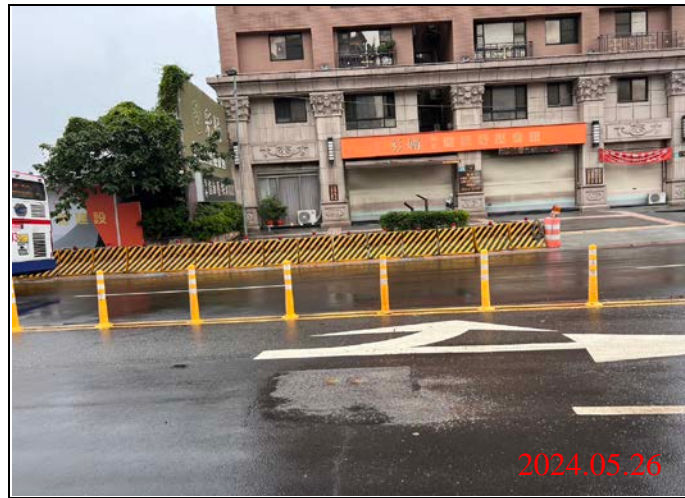
巡查日期地點：113.05.26/ Y22車站 照片說明：南側道路龜裂
