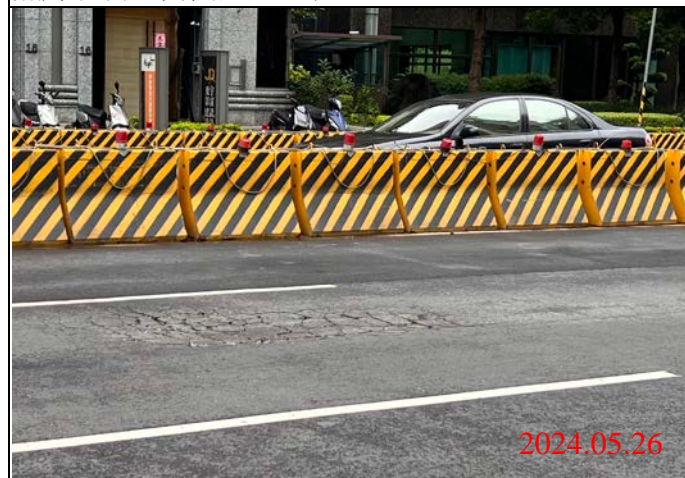
巡查日期地點：113.05.26/ Y23車站 照片說明：南側道路坑洞
