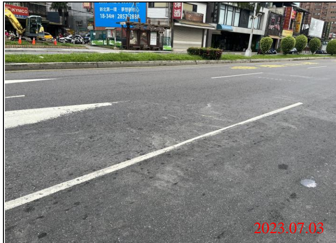
巡查日期地點：112.07.03/ Y21車站 照片說明：路面龜裂狀況
