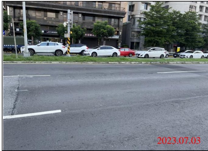
巡查日期地點：112.07.03/ Y23車站 照片說明：路面龜裂狀況
