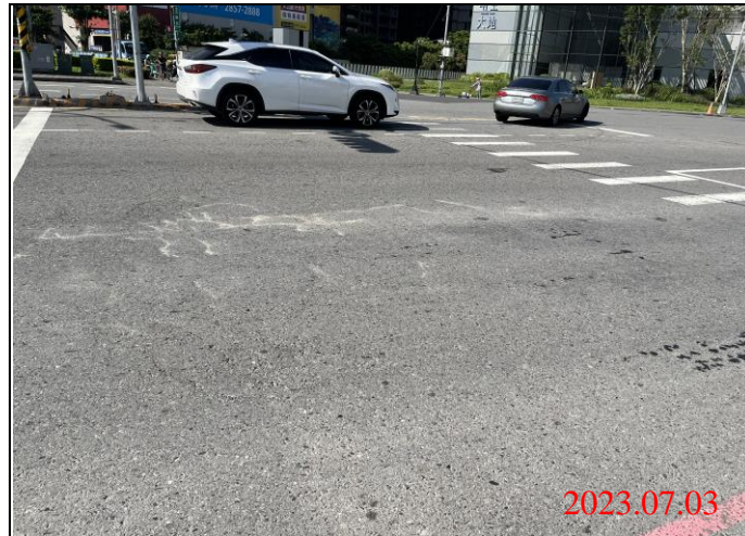
巡查日期地點：112.07.03/ Y22車站 照片說明：路面龜裂狀況
