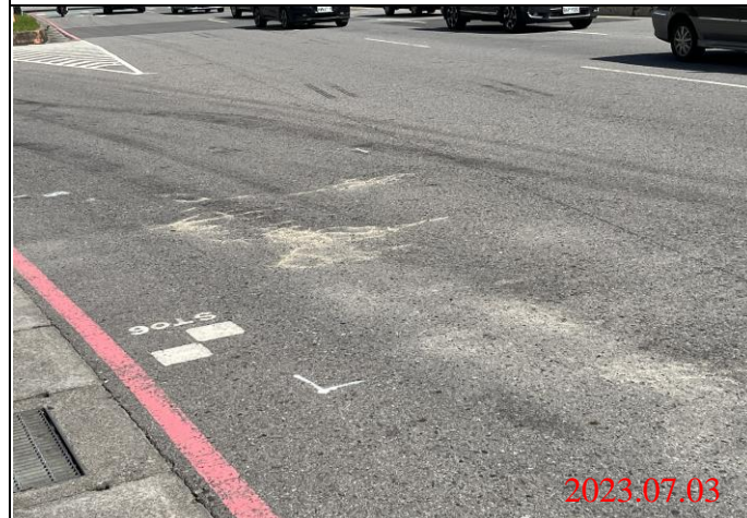
巡查日期地點：112.07.03/ Y23車站 照片說明：路面龜裂狀況
