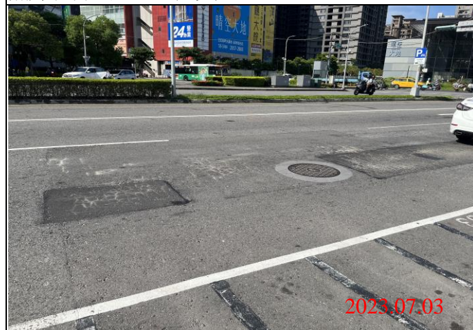
巡查日期地點：112.07.03/ Y2車站 照片說明：路面龜裂狀況
