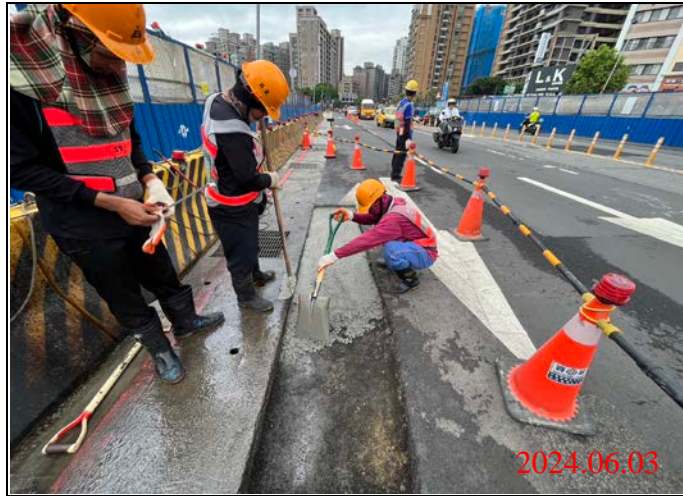
巡查日期地點：113.06.03/ Y22車站 照片說明：道路坑洞
