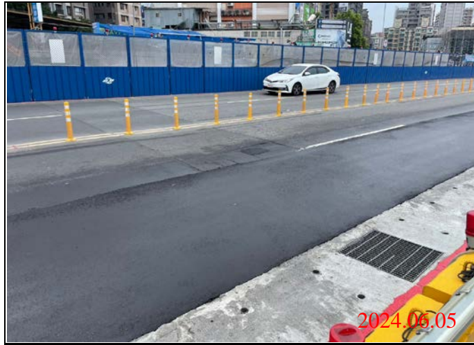
巡查日期地點：113.06.05/ Y22車站 照片說明：路面損壞情況
