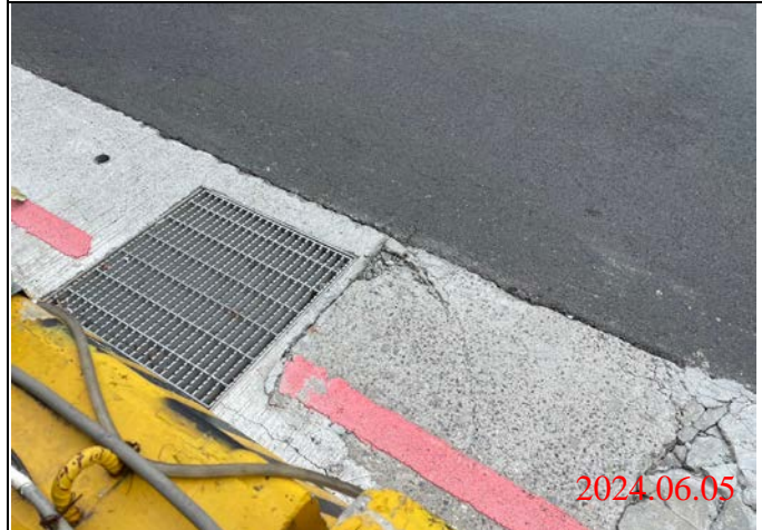
巡查日期地點：113.06.05/ Y23車站 照片說明：路面損壞情況
