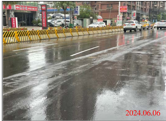
巡查日期地點：113.06.06/ Y32車站 照片說明：路面損壞情況
