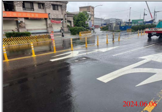
巡查日期地點：113.06.06/ Y22車站 照片說明：路面損壞情況
