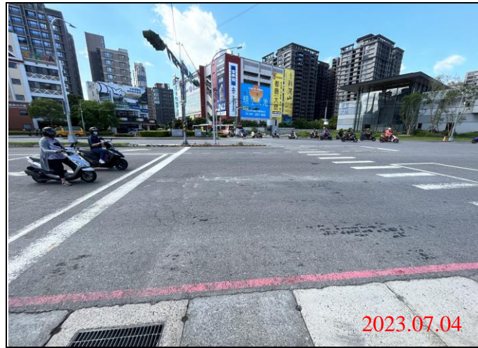
巡查日期地點：112.07.04/ Y22車站 照片說明：路面龜裂狀況
