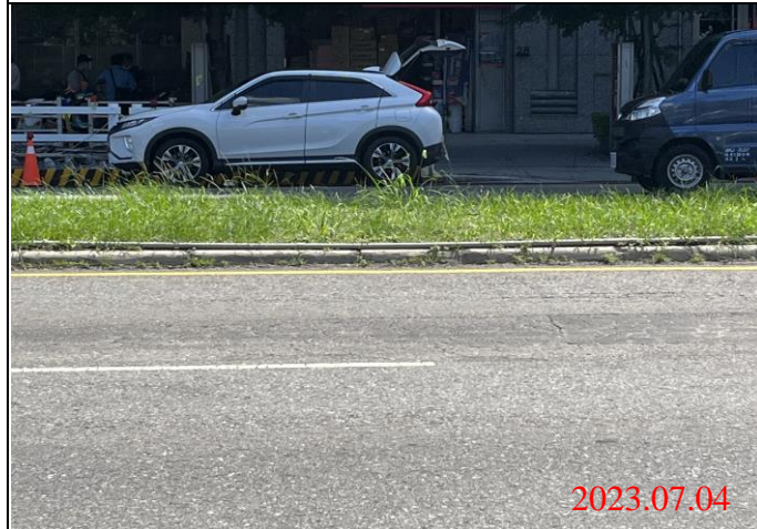
巡查日期地點：112.07.04/ Y23車站 照片說明：路面龜裂狀況
