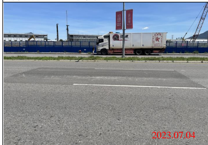
巡查日期地點：112.07.04/ Y2車站 照片說明：路面龜裂狀況
