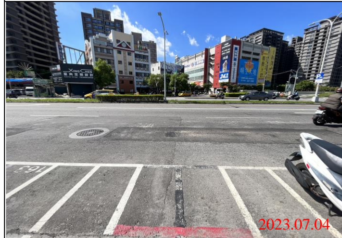
巡查日期地點：112.07.04/ Y22車站 照片說明：路面龜裂狀況
