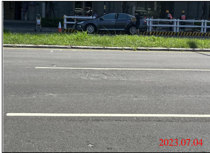
巡查日期地點：112.07.04/ Y23車站 照片說明：路面龜裂狀況
