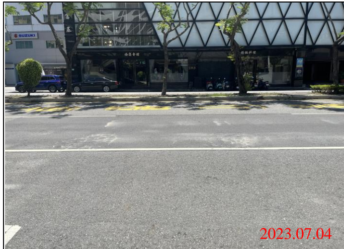
巡查日期地點：112.07.04/ Y21車站 照片說明：路面龜裂狀況
